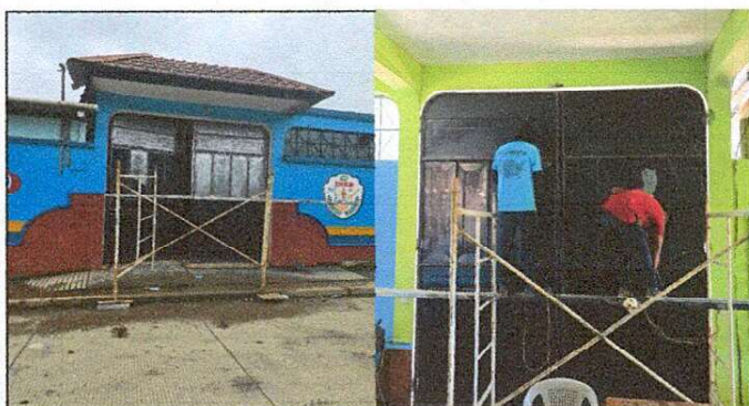
Foto 5: SUSTITUCION DE PORTON POR DETERIORO.
